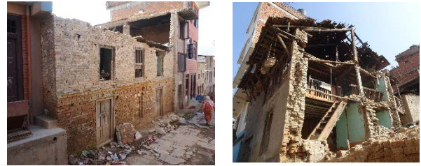
図 5 屋根が崩壊したケース（左）と側面の壁が崩壊したケース（右）
