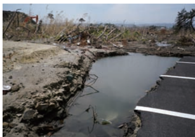
▲地盤沈下の様子
