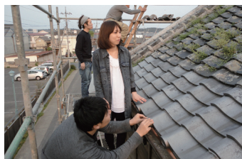
▲蔵の屋根の被害を見るメンバー
