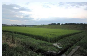
▲堤防の不連続部分
