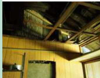
photo4. 二件目玄関先。天井が抜けて吹き抜けに。トタンの壁が見える。
