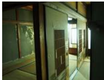
photo2. 一件目2階和室。南面からの日差しが印象的。傷んだ建具は交換か。
